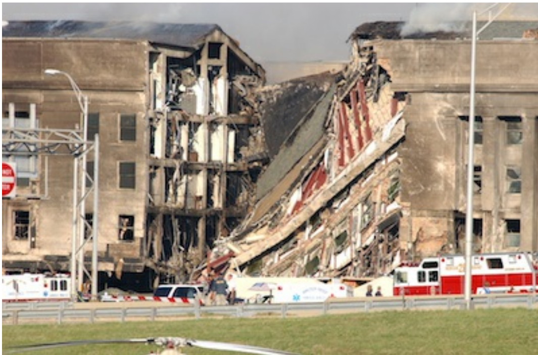
Figura 30. L'immagine mostra chiaramente che sul lato sinistro della breccia la struttura modulare del Pentagono si è aperta
