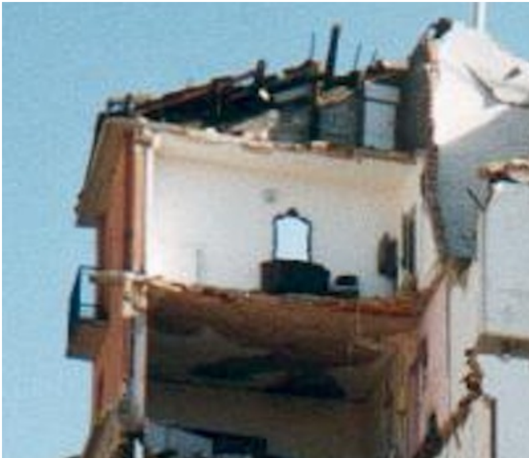
Figura 31. Il crollo parziale di una palazzina a Monza lascia intatti i mobili e persino uno specchio.
